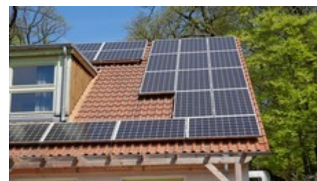
Photovoltaik auf dem Dach und ein sichtbarer Wechslrichter. Die TN können die Energiegewinnung während ihres Seminars ablesen und bekommen ein Gefühl für den Aufwand, der hinter 1 kWh steckt
